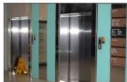
电梯控制器Elevator controller
