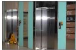
电梯控制器Elevator controller
