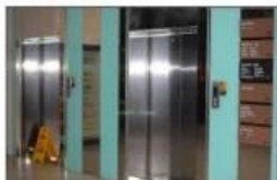
电梯控制器 Elevator controller
